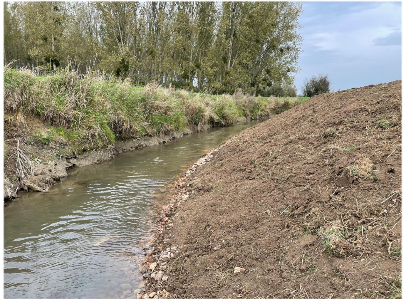
Positionnement de jalons en limite de ligne dynamique d'écoulements Remplissage de matériaux issus des merlons
